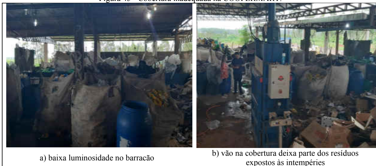
Figura 45 - Cobertura inadequada na COOPERMART.
