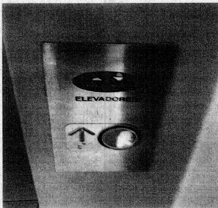
Figura 38 – Detalhe do acionamento do elevador
