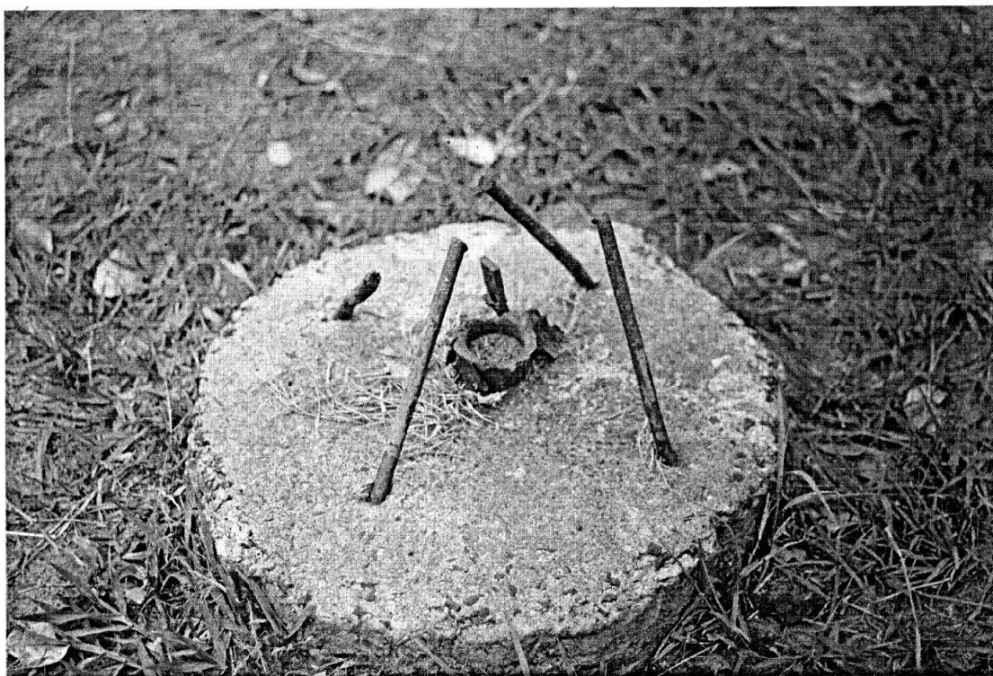
Vergalhões de ferro totalmente expostos gerando um risco eminente para os frequentadores do local.
