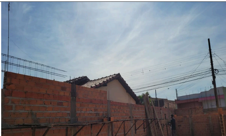
Imagem 13 – Muro de divisa e ferragens
