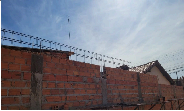
Imagem 14 – Muro de divisa e ferragens
