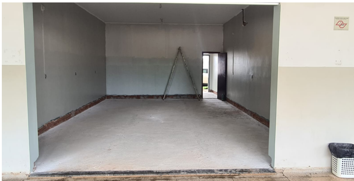
PAREDE PINTADA FALTANDO ACABAMENTO E PISO CONCRETADO
